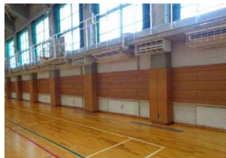
第1体育館エアコン
